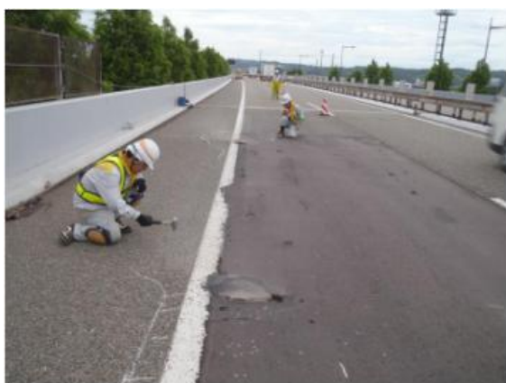
図-4 たたき点検による床版上面の浮き推定
