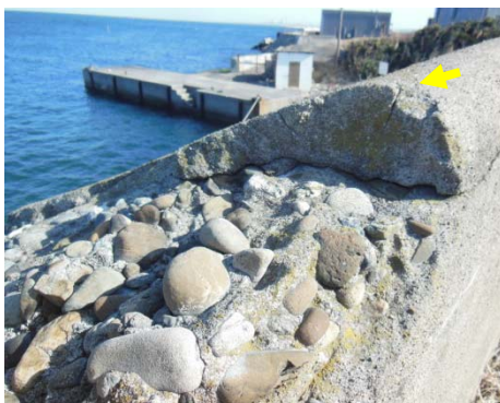
写真4 パラペットの現況
